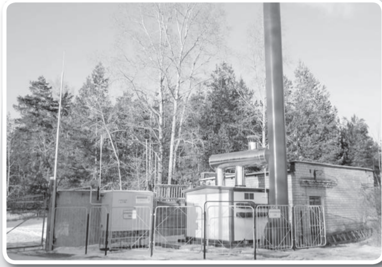
Блочно-модульная котельная участка ВОС
