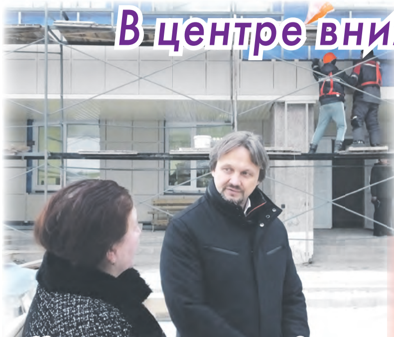
Обсуждение хода ремонта школы в селе Сосново с директором Чайковского УКСа Раушанией Гизитдиновой
